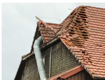
Dégâts causés par l'ouragan Burglind le 3 janvier 2018 à Prez-vers-Noréaz
